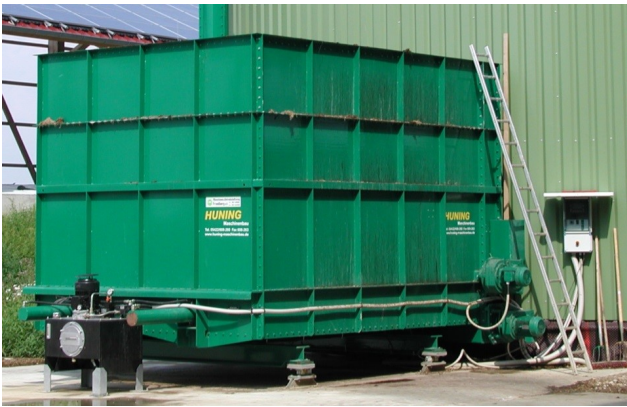
Abb. 6: Stahlcontainer mit Schubbodensystem; SICHERHEITSHINWEIS: Die Leiter ist gegen Abrutschen zu sichern! (Foto: LfL)
