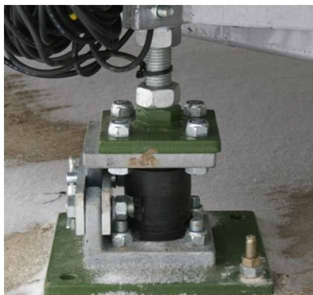
Abb. 2: Stützfuß eines Feststoffvorlagebehälters auf einer Wiegezelle (Foto: LfL).
