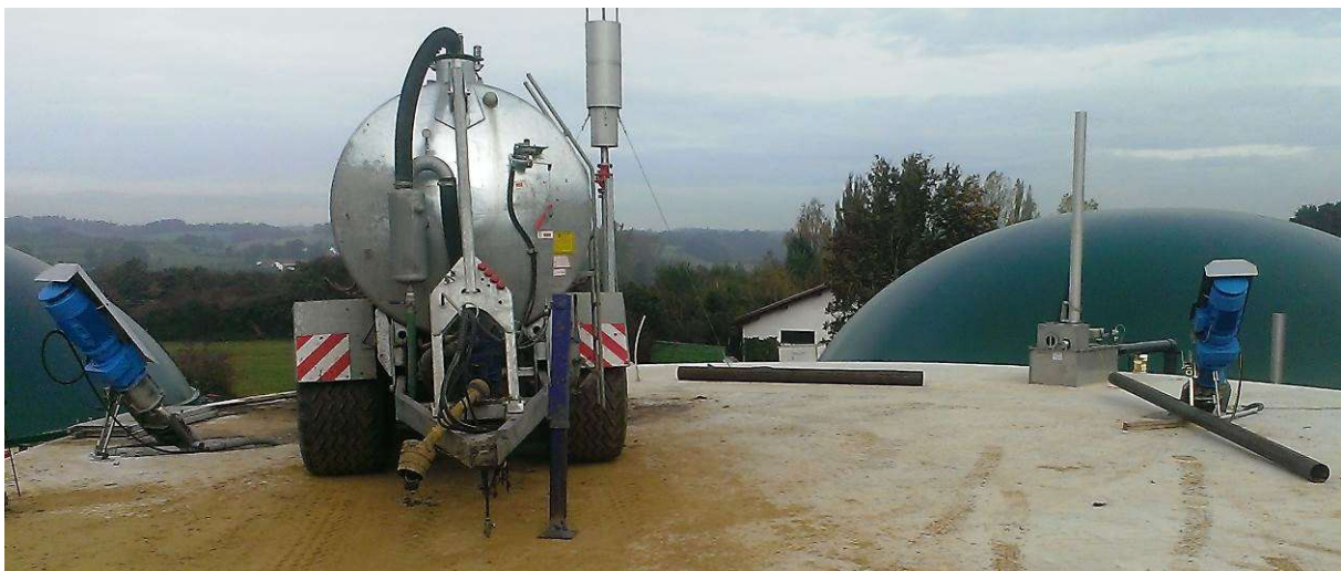
Abbildung 7: Kombination aus schiebendem (links) und ziehendem (rechts) Stabmixer in einem Fermenter mit Betondecke
