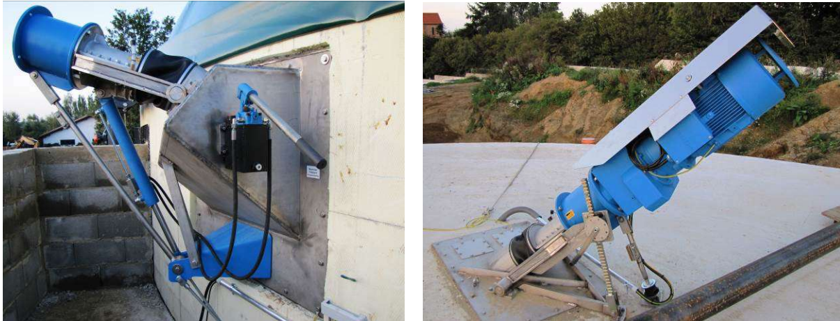
Abbildung 5: Durch die Behälterwand bzw. -decke geführter Stabmixer mit hydraulischer (links) bzw. mechanischer (rechts) Vorrichtung zur Verstellung der Wellenneigung
