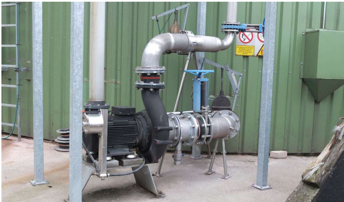
Abbildung 15: Kreiselpumpe mit Schneideinrichtung als Zirkulationspumpe in der Bypassleitung eines Fermenters
