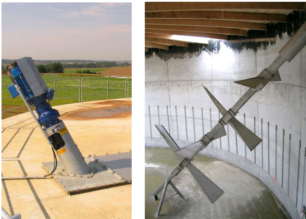
Abbildung 8: Langachsrührwerk mit Decken- und Wanddurchführung der Rührwelle (Foto: LfL / Dyckhoff)
