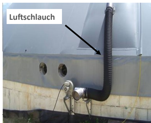
Abb. 3: Zufuhr Tragluft in Gasspeicher (Quelle: Sattler / CenoTec)
