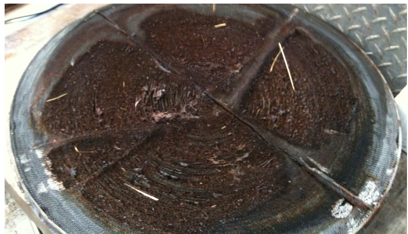
Bild 2: Katalysatorelement mit thermischer Zerstörung (Quelle: Air Sonic GmbH)
