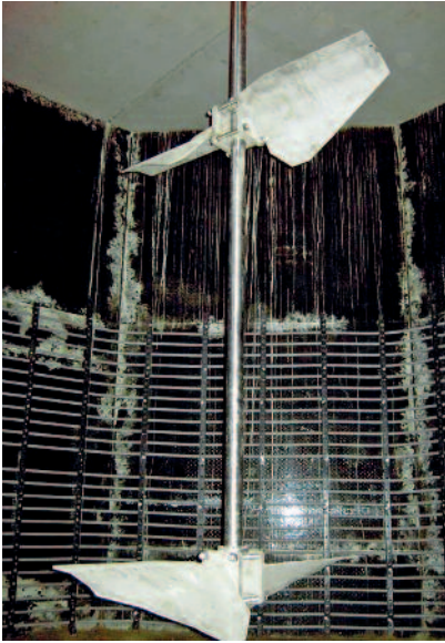
Zentralrührwerk in Gärbehältern nach dänischer Bauweise (Behälterhöhe ~ Behälterbreite). Foto: LfL
