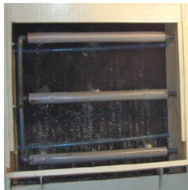
Draufsicht auf einen Abluftwäscher.
